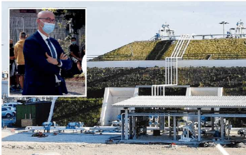
Il deposito Gpl a Punta Colombi. Nel riquadro, il ministro Federico D'Incà, che ha rassicurato la città
