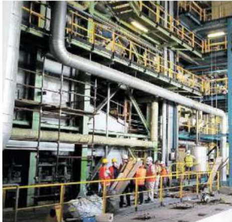
LA PRIMA LINEA L'impianto "LI" di Veritas a Fusina e, in alto a destra, il camino di 60 metri da cui escono i fumi già filtrati
